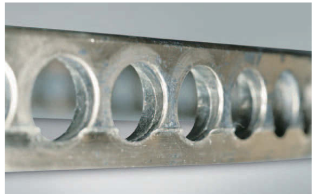
Foto 7.8 Bauteil: Käfig eines Schrägkugellagers Symptom: Stufenförmige Abnutzung an der Mantelfläche und der Taschenfläche des Messingmassivkäfigs
